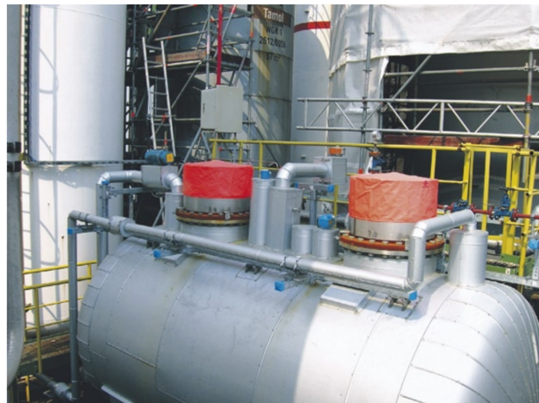
Abb. 3: Das Halfen Powerclick-System erlaubt auch flexible Rohrhalterungen an Behältern im Außenbereich.
