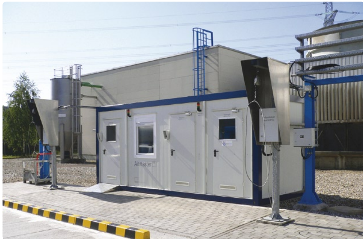
Modulare Komplettlösung hier als Stand-alone-Version: An den beiden Sample Points werden Proben der verladenen Gase entnommen und automatisch im Container analysiert. Die Warenausgangszertifikate liegen anschließend zur Ausgabe bereit.
