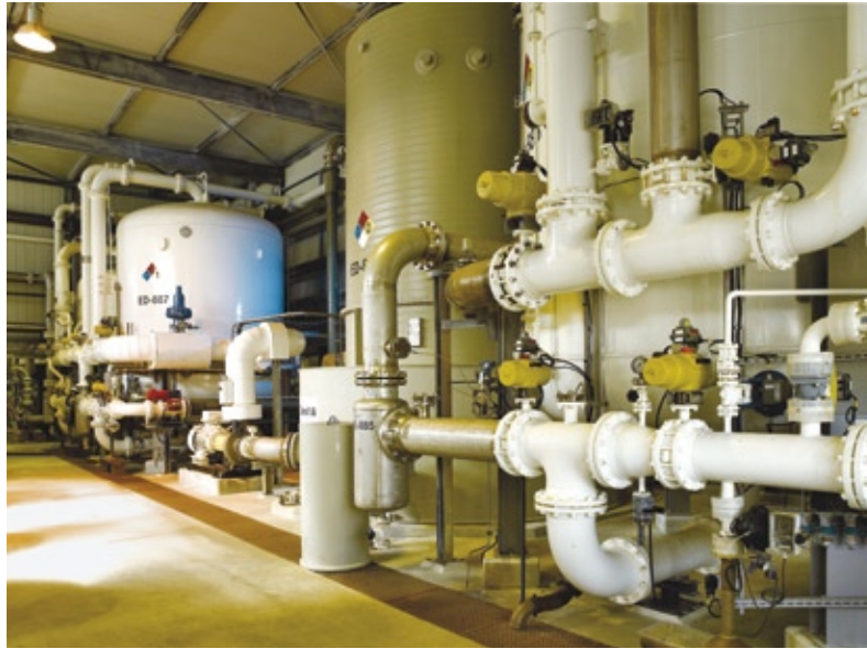
VE-Wasseraufbereitung bei Dow Chemical in Stade
