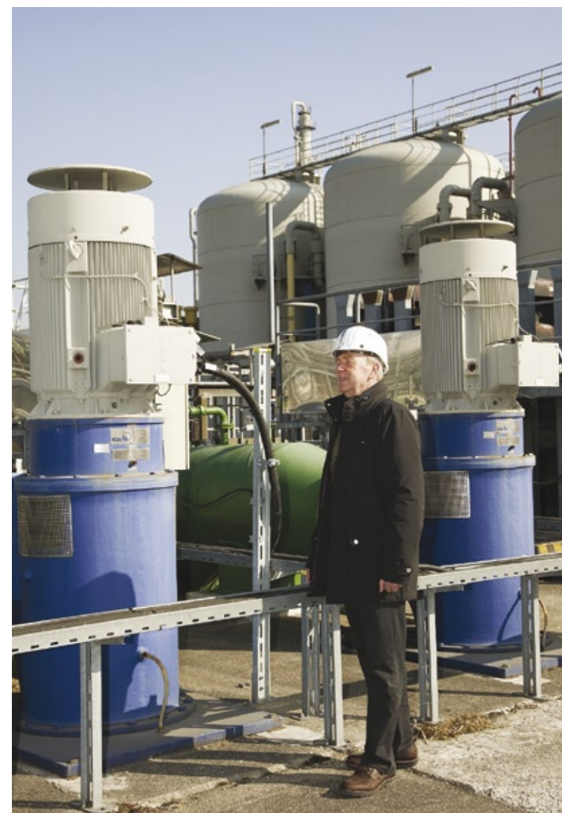
Abb. 3: Hartmut Taubert beim Kontrollgang an den Siemens-Motoren und KSB-Hebepumpen, im Hintergrund die neuen Kiesfilter des Burghauser Wasserwerkes.
