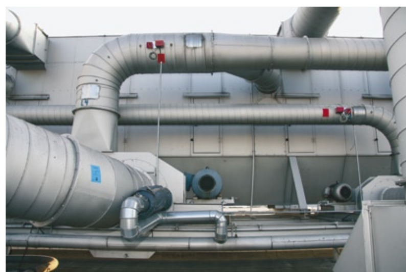
Abb.: Vorbildliche Sicherheitstechnik auf einen Blick: Funkenerkennung und Funkenlöschung
