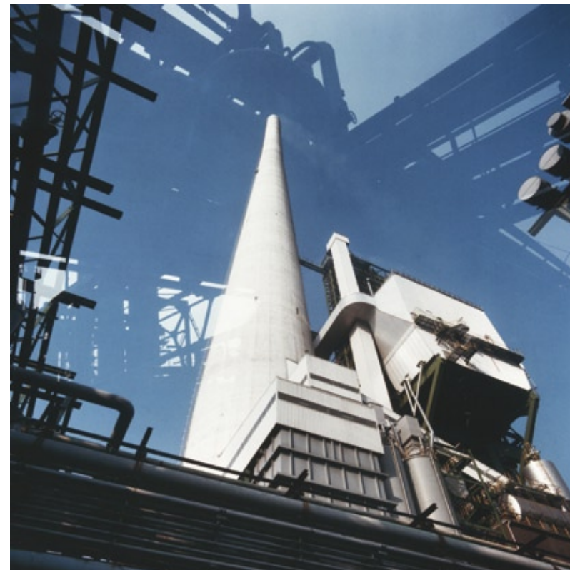
Infracor betreibt im Chemiepark Marl Kraftwerke mit insgesamt drei Kohle- und zwei Gasblöcken.
