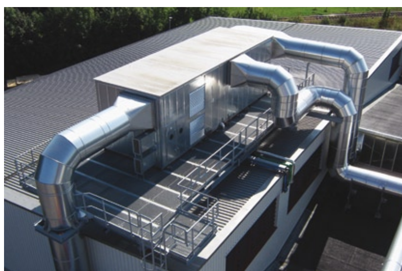
Zweistufige Wärmerückgewinnung bei Dachaufstellung
