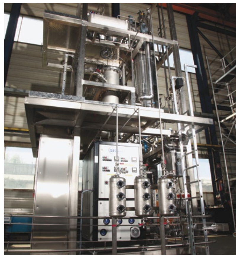
Diese von GIG Karasek geplante und errichtete 2-stufige Destillationsanlage umfasst Dünnschicht- und Kurzwegverdampfer und wird zur Lösemittelabtrennung im Hochvakuum bei einem Schweizer Pharmaunternehmen eingesetzt.
