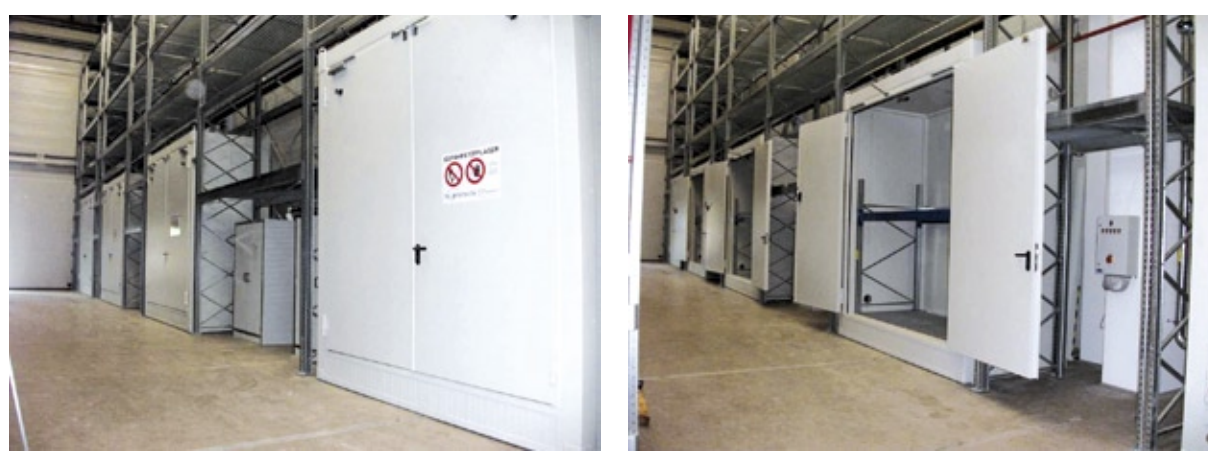
Investition in die betriebliche Sicherheit: Diese brandschutzgeschützten Protecto-Regallager wurden exakt nach Kundenwunsch in ein bestehendes Warenlager integriert. Die zweiflügeligen Türen der Gefahrstofflager schließen sich im Brandfall automatisch.
