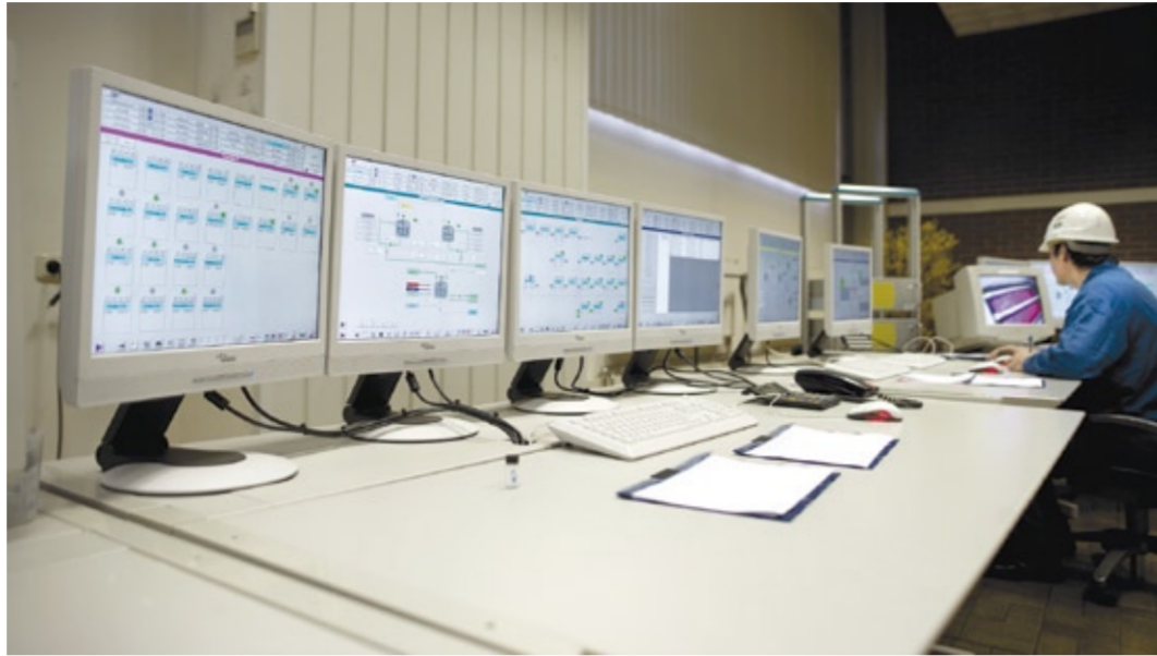
Abb. 1: Bis zu vier Monitore gleichzeitig versorgen einige der neuen Simatic WinCC-Clients in der Leitwarte mit aktuellen Prozessdaten aus der Wirkstoffproduktion bei BASF Pharmachemikalien in Minden. Die neue Client-Server-Architektur ermöglicht den Zugriff auf sämtliche Anlagen-teile an jedem WinCC-Bedienstand im Betrieb. Das spart lange Wege und erhöht die Verfügbarkeit.
