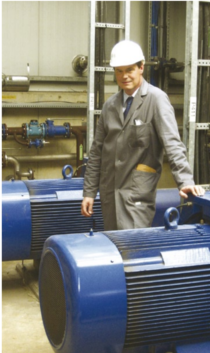
Abb. 1: Im Industriepark in Duisburg-Meiderich wurden die 11 Pumpenantriebe der Kühlwasseranlage modernisiert, d.h. die Antriebsmotoren getauscht. Durch die effizienteren EFF1-Motoren werden erhebliche Energiekosten eingespart. Harald Oehlandt, Betriebsleiter der InfraTec Duisburg, mit einer Amortisationszeit von unter einem Jahr hat die Modernisierungsmaßnahme ihre Zweckmäßigkeit von Anfang an bewiesen. (Foto: InfraTec)
