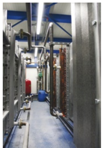
Über die Wasserkühlung der Kompressoren wird rund 80 Grad heißes Wasser für die Vorwärmung von Prozessluft über großflächige Wärmetauscher (Kupfer, rechts) zur Verfügung gestellt.
