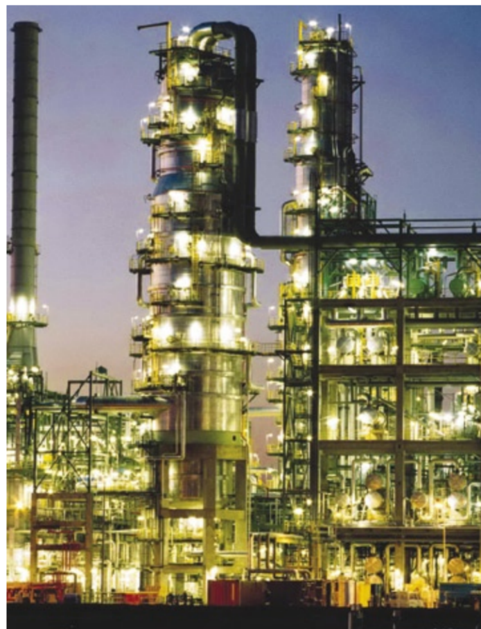
Professionelles Instandhaltungsmanagement durch entsprechende Dienstleistungen von Bilfinger Berger Industrial Services leisten einen messbaren Beitrag zu Produktivität und Wettbewerbsfähigkeit der Anlagenbetreiber.
