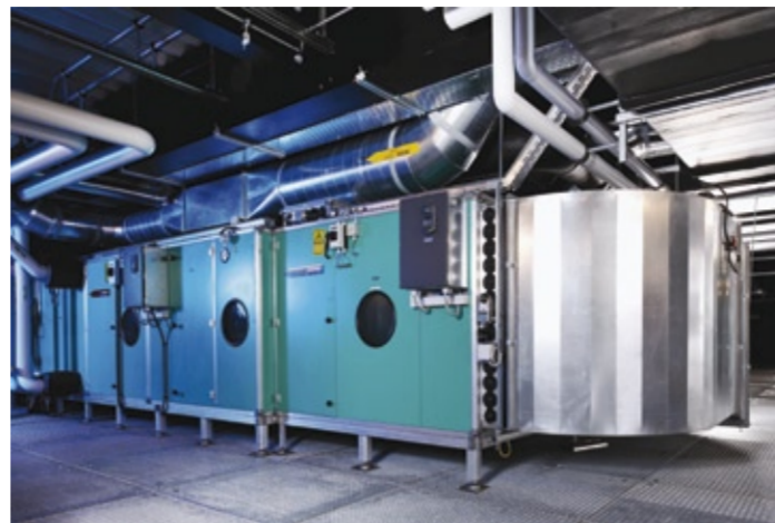
Heizungs-Klima- und Lüftungsanlagen schlucken ca. 65% der Energie in der Pharmaindustrie
