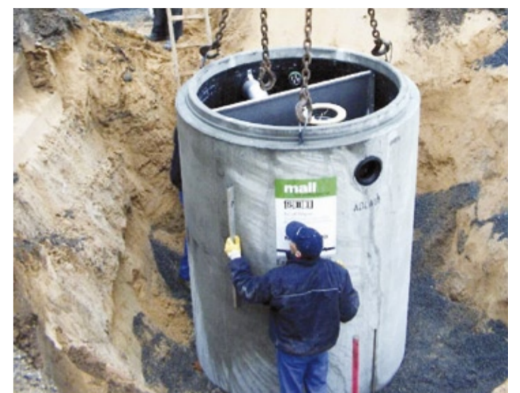
Abb.3: Leichtflüssigkeitsabscheider gewährleisten zuverlässigen Rückhalt von Benzin, Diesel und Öl. (Foto: Mall)
