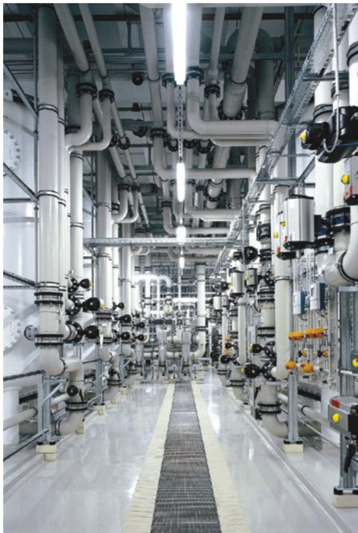
Abb.1: Ein flüssigkeitsdichter Boden ist Pflicht, wenn wassergefährdende Stoffe im Spiel sind. (Foto: Stocretec)
