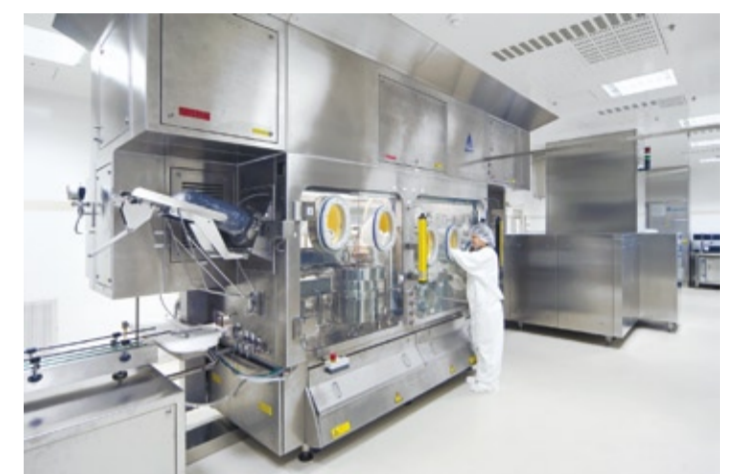
Abb. 2: Der Abfüllprozess verläuft vollautomatisch und unter Isolatorbedingungen.
