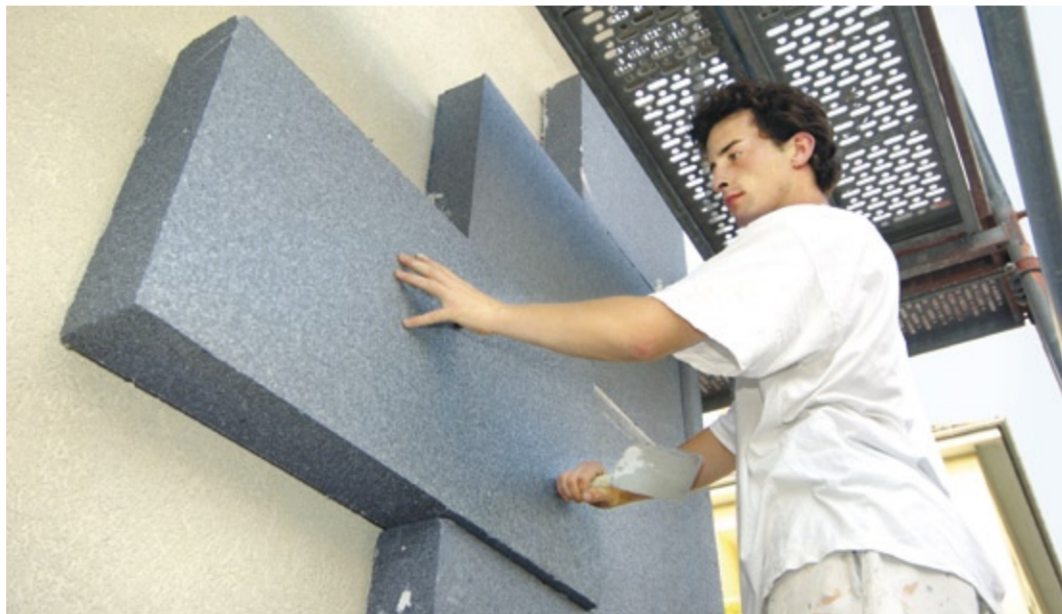
Mit einer flächendeckenden Dämmung von Altbauten könnte Deutschland pro Jahr über 80 Mio. t CO 2 einsparen – das entspricht der Hälfte des jährlichen CO 2 -Ausstoßes des deutschen Kraftverkehrs.
