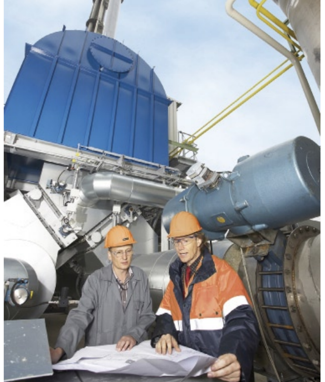
Die Renovierung der Thermischen Abluft-Anlage (TVA) im Chemiepark Dormagen ermöglichte eine CO 2 -Reduzierung von 18.000 t/a.
