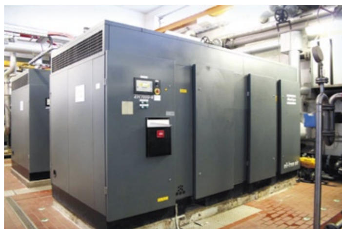
Die beiden neuen Turbokompressoren bei Evonik Degussa (Bild: Atlas Copco)
