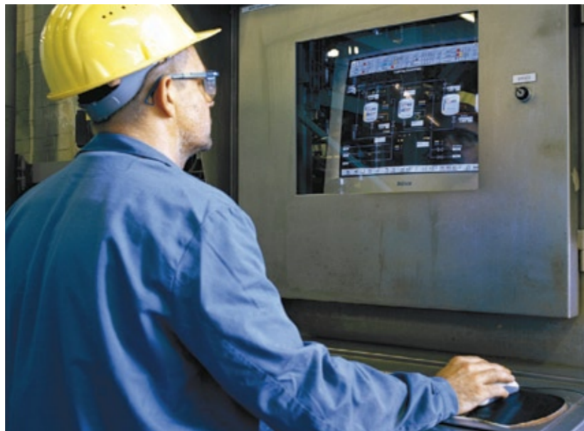
WinCC-Client in Ex-Schutz-Gehäuse: Einer von insgesamt acht Simatic WinCC-Bediencents, hier im exgeschützten Bereich der Anlage.
