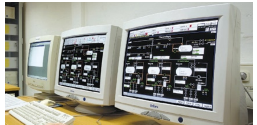
Abb. 3: Coros/WinCC-Anzeigen in Kemira-Wartungsraum, mit Bedienbildern: Die Übersicht der Blankophor-Anlage im Look von Coros LSB und unter Simatic WinCC nach der Migration.
