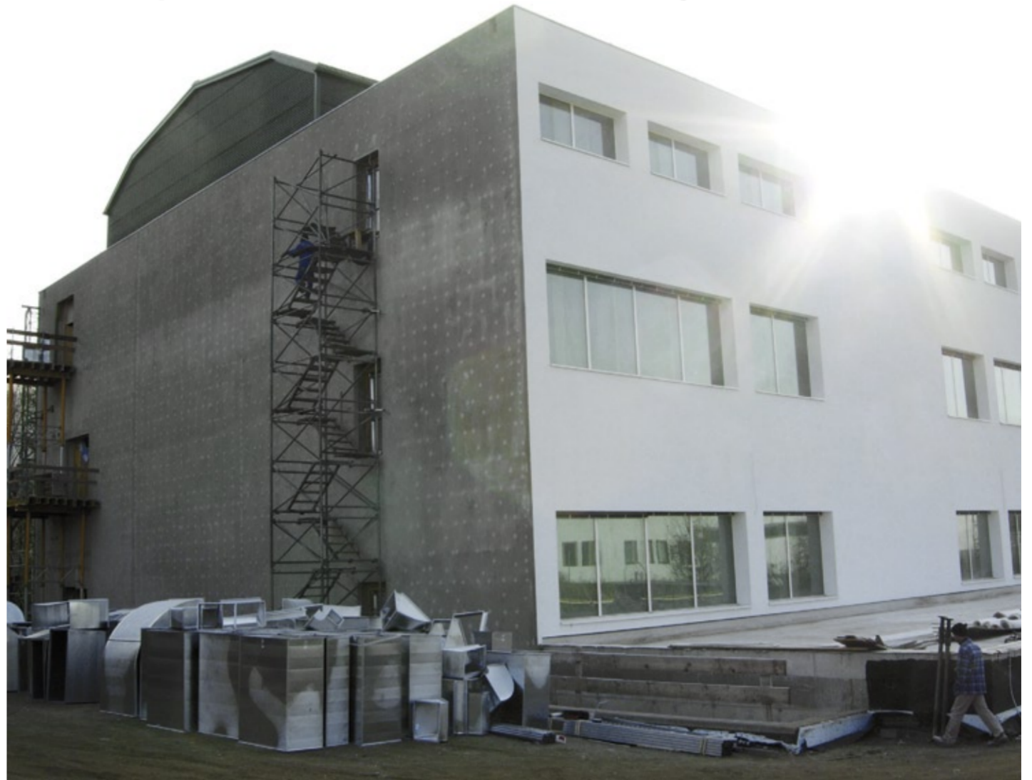
Abb. 5: Stand des Bauprojektes im Dezember 2007: Rohbau Produktion Gebäude 1 fertig gestellt, Gebäudehülle dicht, Wärmedämmverbundsystem an Fassade fertig gestellt.
