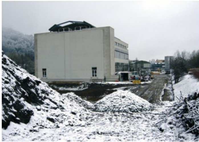
Abb. 1: Neubau der Pharmaproduktion von Hermes Pharma in Wolfsberg, Österreich, zum Baubeginn im März 2007. Baufeld auf dem Gelände Werk II mit Beginn des Erdaushubs für das Gebäudeteil 1 (Bilder jeweils von Norden aus gesehen).
