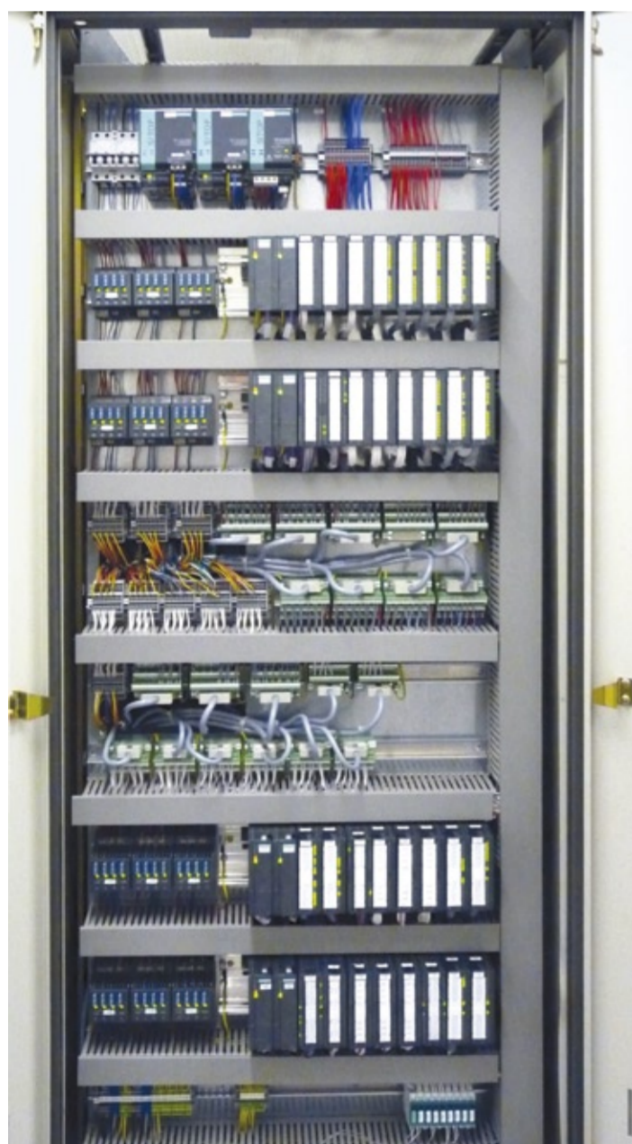
Mit sogenannten Field Termination Assemblies (FTAs) wurden die Frontstecker der alten E/A-Baugruppen auf die neuen Baugruppen geschaltet. Beim Factory Acceptance Test wurden sämtliche Steckverbindungen überprüft und so Verdrahtungsfehler schon vor dem Umschluss sicher eliminiert. (Foto: Finze & Wagner)
