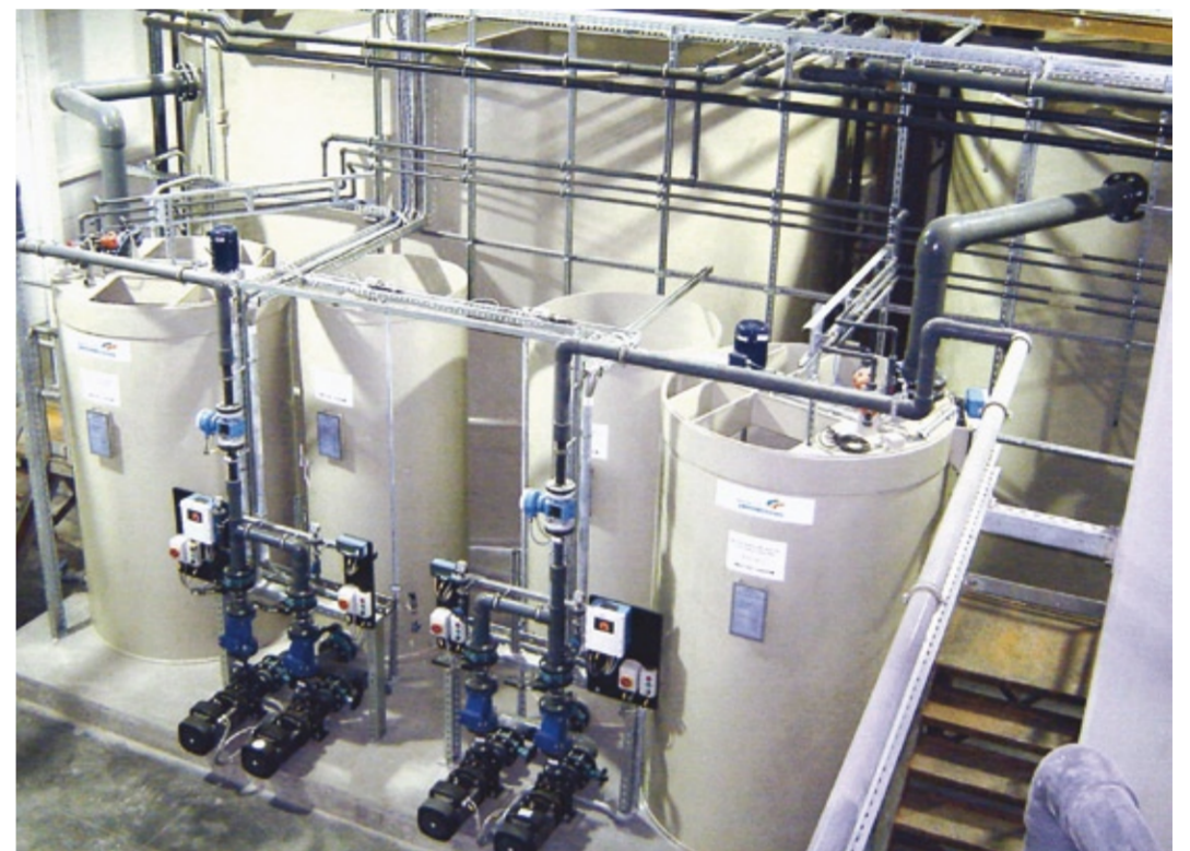
Der Systempartner für Wasser- und Abwassertechnik stellt den Betrieb der Anlagen sicher, und der Kunde kann sich ganz auf sein Kerngeschäft konzentrieren.
