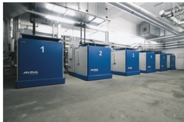
Die Druckluftstation bei der SGL Group in Meitingen: Sechs öleingespritzte Schraubenkompressoren mit integrierter Wärmerückgewinnung erzeugen hier die Druckluft, die im Sommer durch die wirtschaftlichere Kältetrocknung; im Winter durch eine zusätzliche außen temperaturabhängige, vollautomatisch zuschaltbare Adsorptionstrocknung aufbereitet wird.
