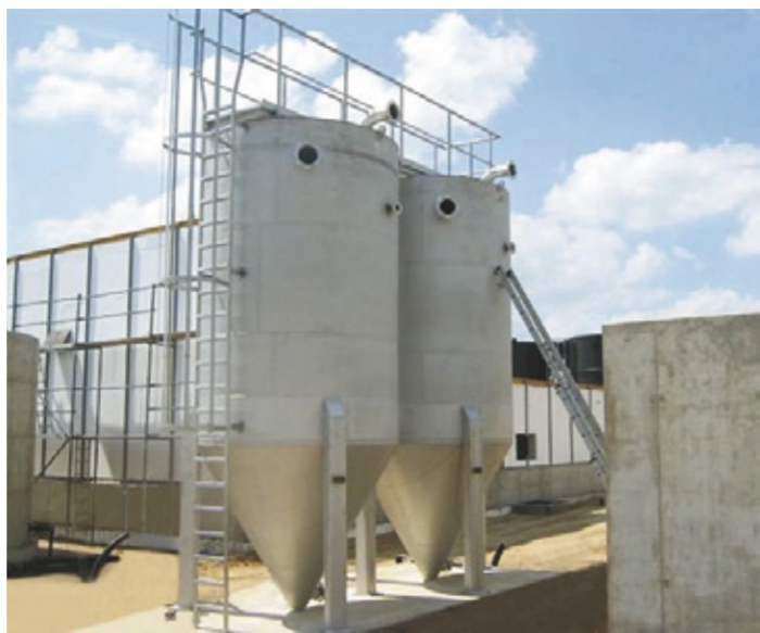
Die Wasseraufbereitung im Kraftwerk spielt eine Schlüsselrolle für Energieeffizienz und Betriebssicherheit. Das Filtrationssystem für die Kühlturmanlage besteht aus sechs kontinuierlichen Contifilt-Sandfiltern.
