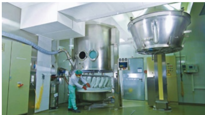
Abb. 1: Wirbelschicht-trocknersack in einem Pharmabetrieb
