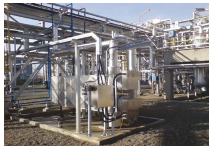
Abb. 1: Ein elektrischer Durchlauferhitzer von Schniewindt sorgt für eine hohe Prozessqualität in einer Produktionslinie zur Herstellung organischer Verdünnungsmittel (Entschwefelung von Benzin) in der Raffinerie Nafty Jedlicze in Polen.
