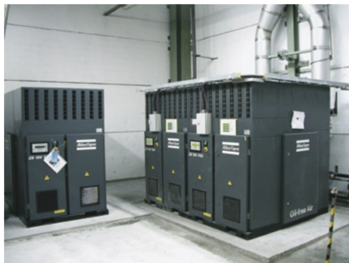
Die neuen drehzahlgeregelten Turboverdichter der Kläranlage im Chempark Krefeld-Uerdingen
