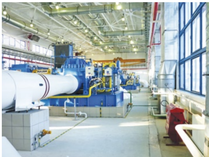
Pumpstation der ESPO-Pipeline mit Pumpen von Sulzer in Betrieb
