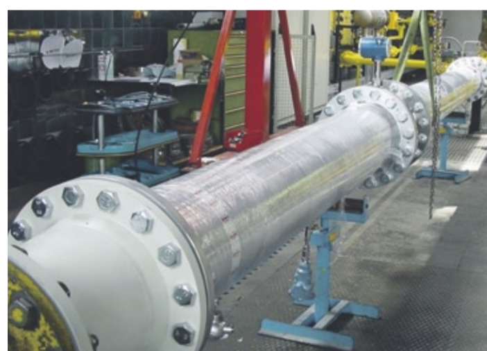
Dampfverrechnungsmessung mit Wirbelzähler
