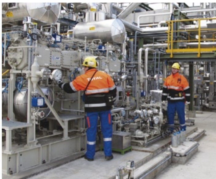
In der Total-Raffinerie in Leuna stellte Technip Ende 2009 eine neue Entschwefelungsanlage fertig.
