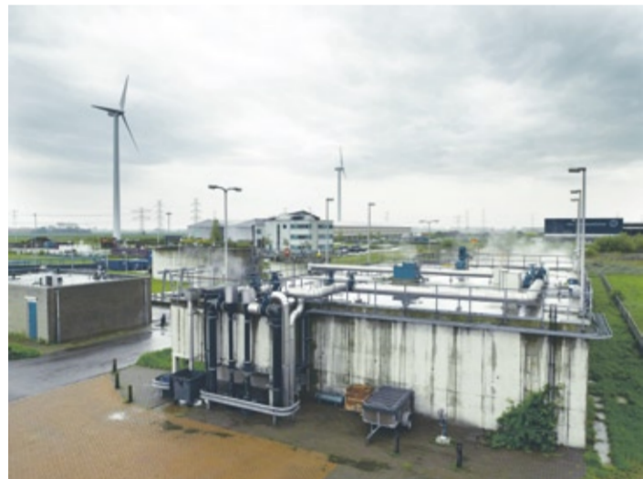
Industriekläranlage im Industriegebiet von Vlissingen
