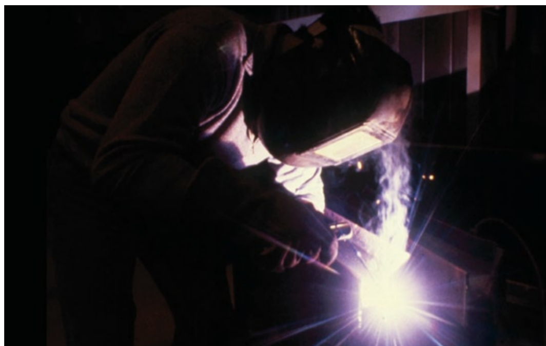
Heißarbeiten können zu unvorhergesehenen Schäden führen.
