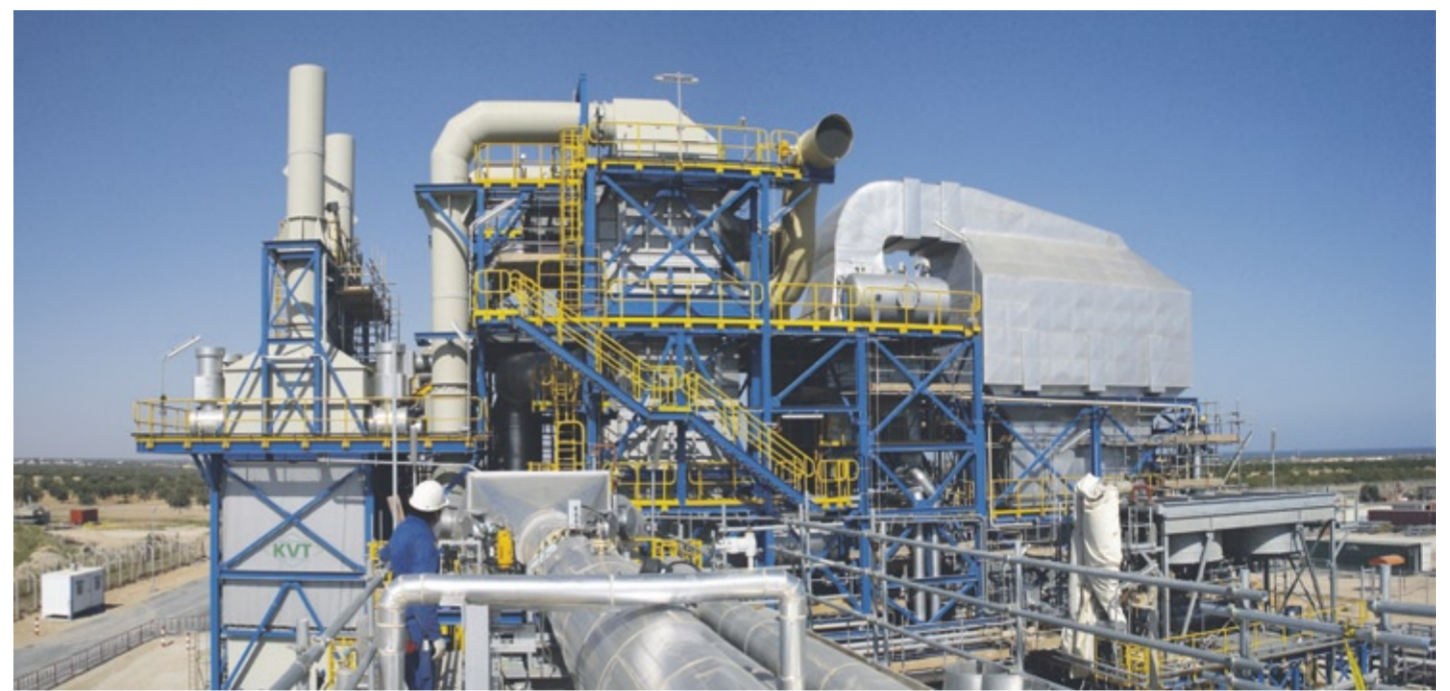
Weltweit realisiert Kanzler VT verfahrenstechnische Anlagen wie diese Sulfox-Anlage in Tunesien.
