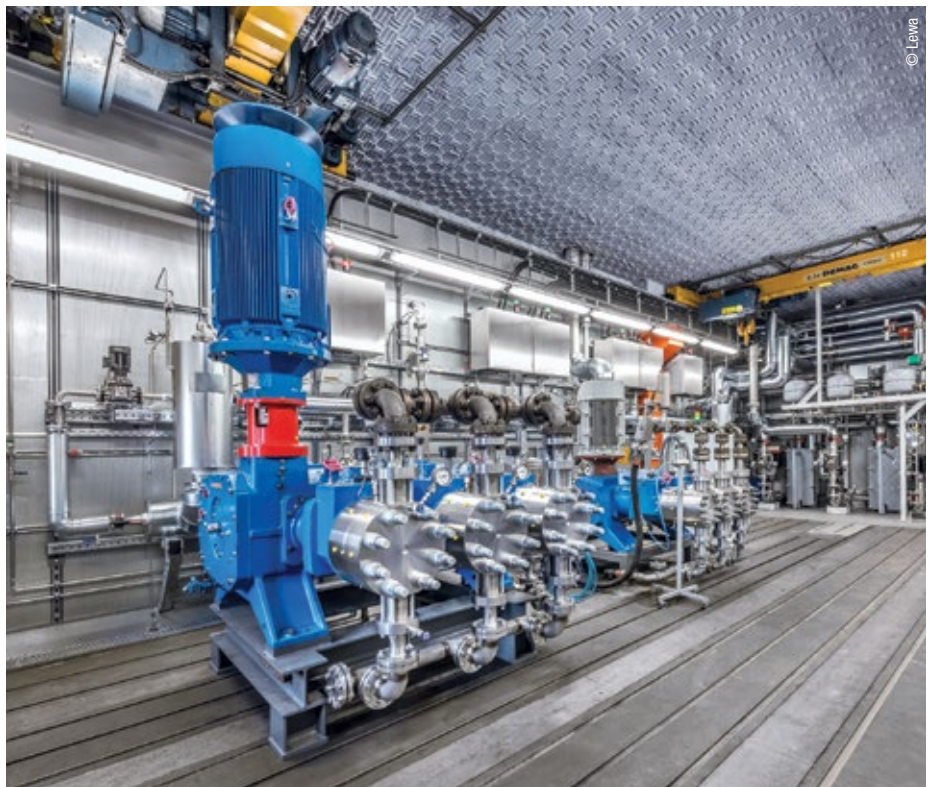
Abb.: Seit Januar 2017 können im frisch sanierten Prüfraum von Lewa bis zu vier Prozesspumpen mit einer Gesamtleistung von insgesamt 800 kW parallel überwacht werden.
