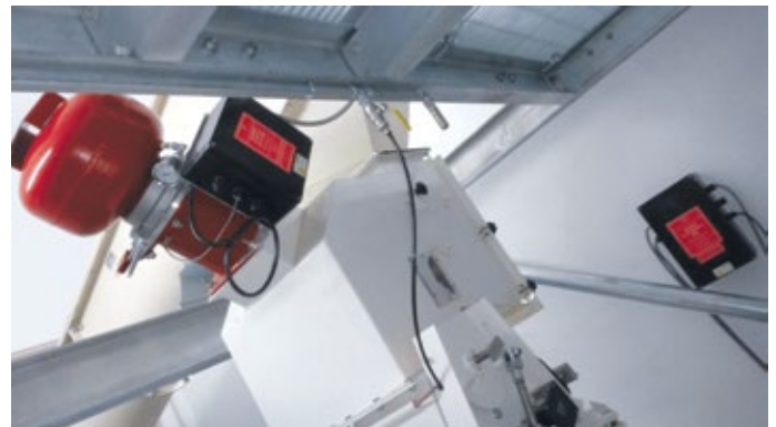
Abb.2: Das System kann in jeder beliebigen Lage eingebaut werden und eignet sich auch für ungünstige Platzverhältnisse – hier an einer Hammermühle in der Pharmaproduktion.
