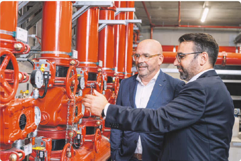
Michael Kriegel (li.) und Florian Steinbrunn, Contract Logistics Manager im Logistikzentrum Karlsruhe, auf einem Rundgang im neuen Gefahrstofflager in Rastatt.
